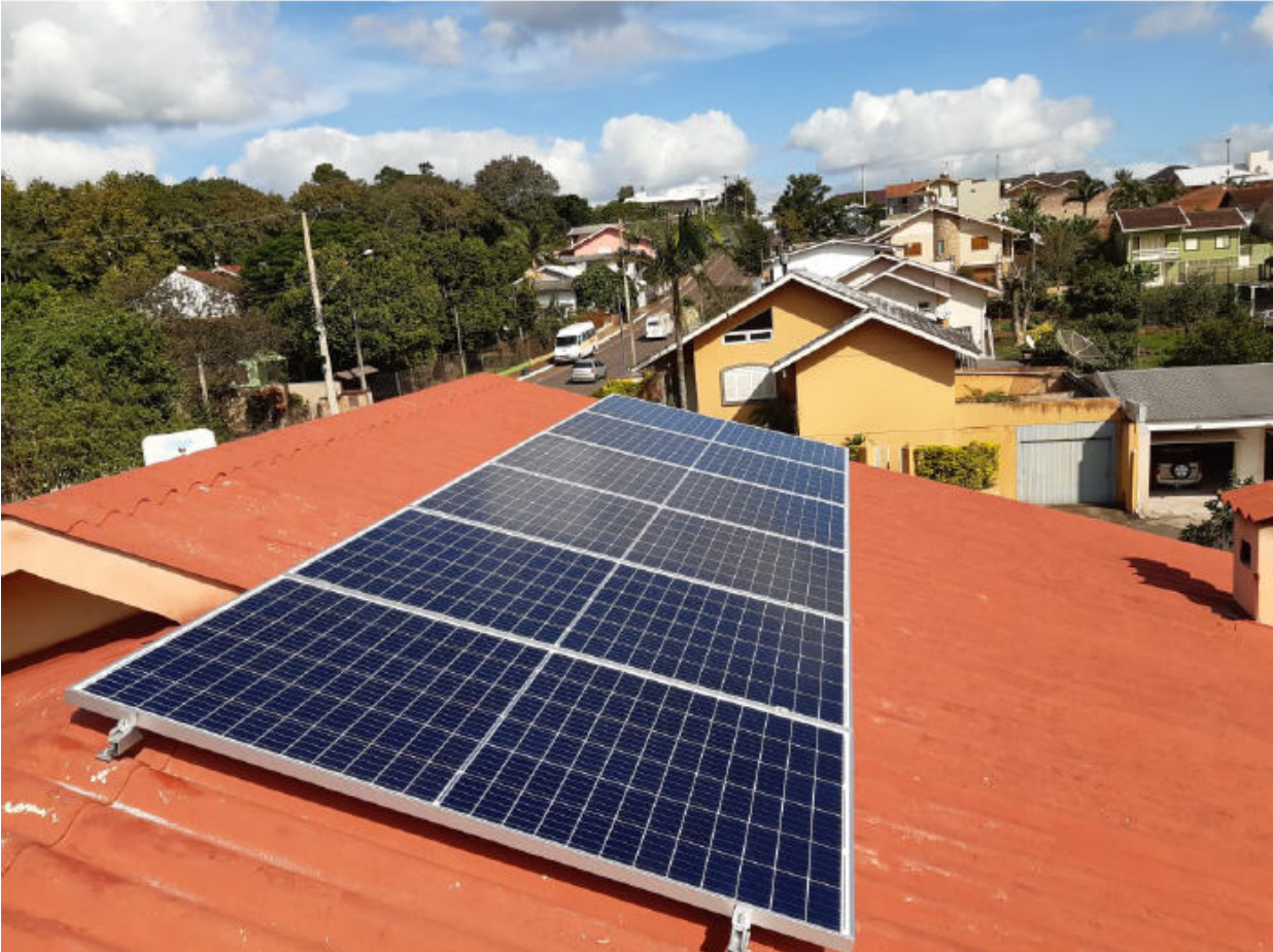
Figura 4 - Sistemas de micro e mini geração: definidos pela potência instalada
